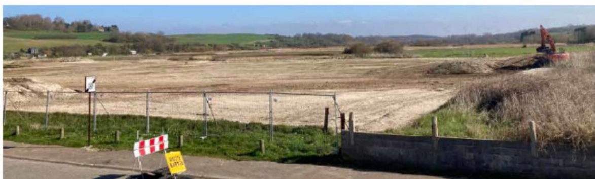
Quiberville-sur-Mer - Renaturation complète de l'ancienne assiette foncière du camping après sa relocalisation
